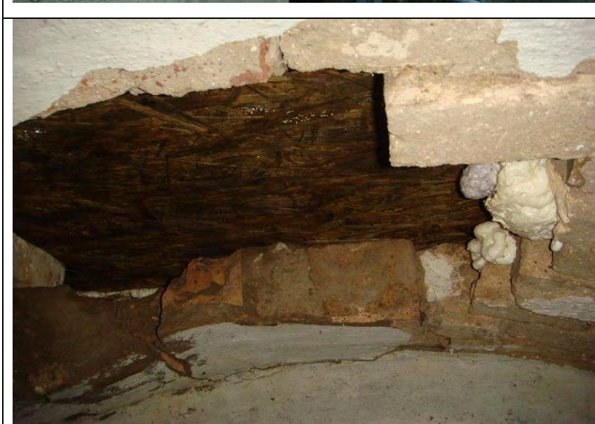
Fotoabb. 113: Sanierungsbedürftiger Deckenbereich, die OSB-Platten sollten entnommen und durch beständige Materialien ersetzt werden.
