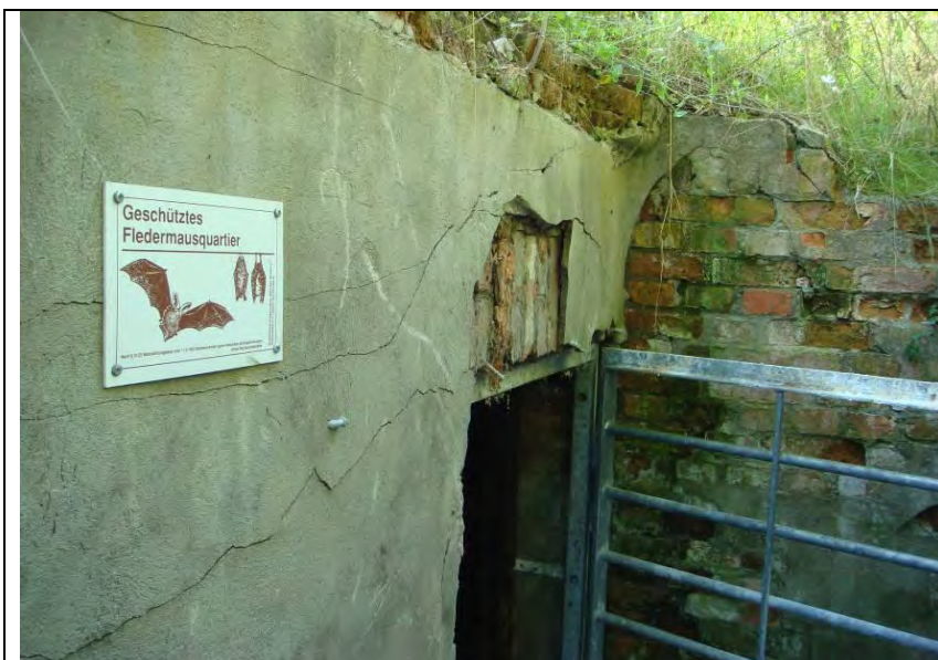
Fotoabb. 112: Verwahrter Eingangsbereich zum Fledermaus-Quartier Waldhaus Dörlau
